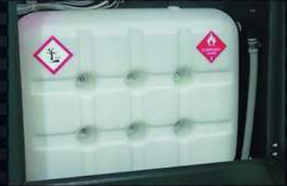
Atık Su Bekleme Tankı
