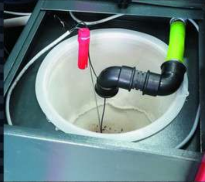
Atık Su Filtreleme Bölümü
